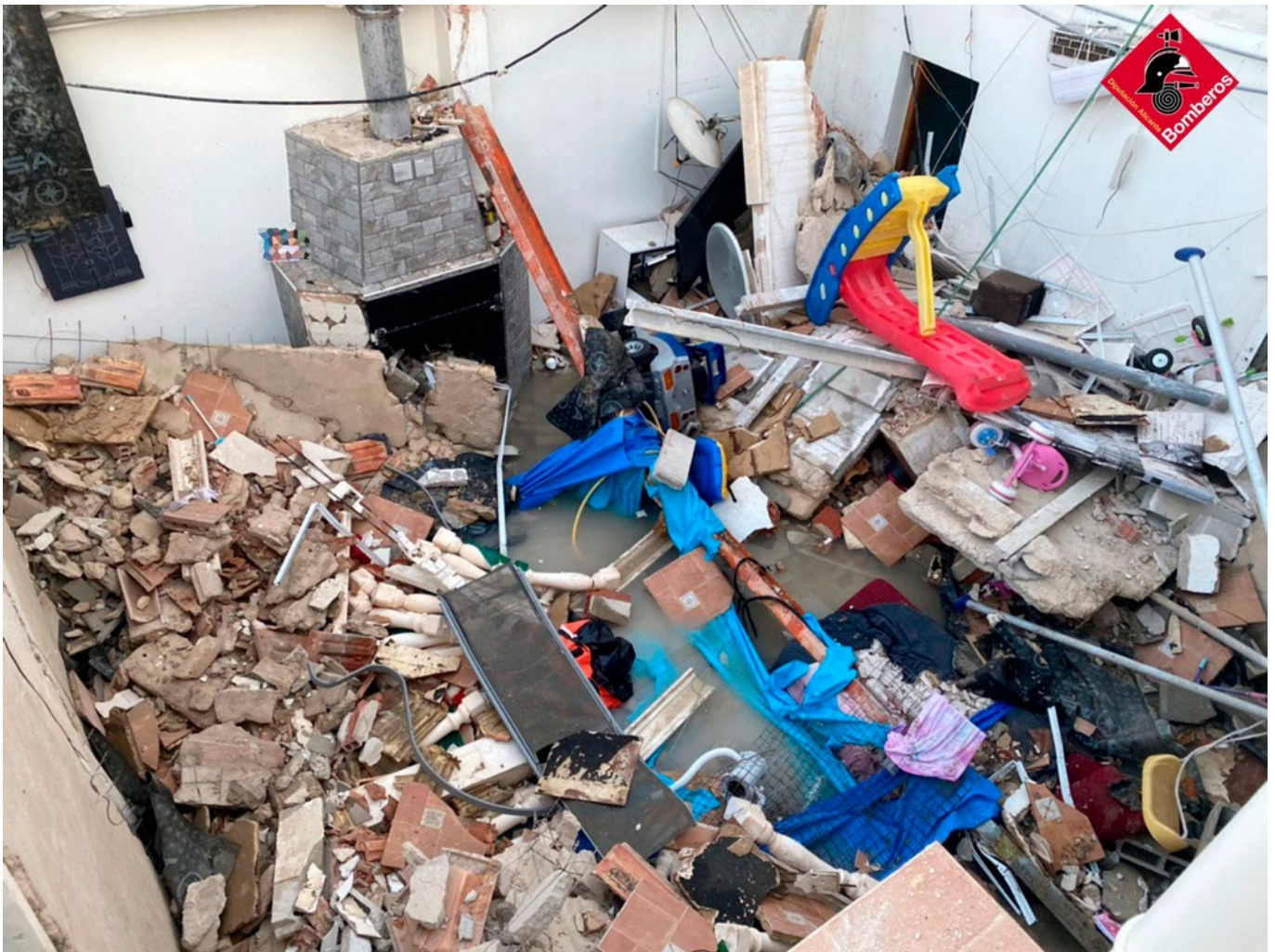
Imagen de los destrozos.
