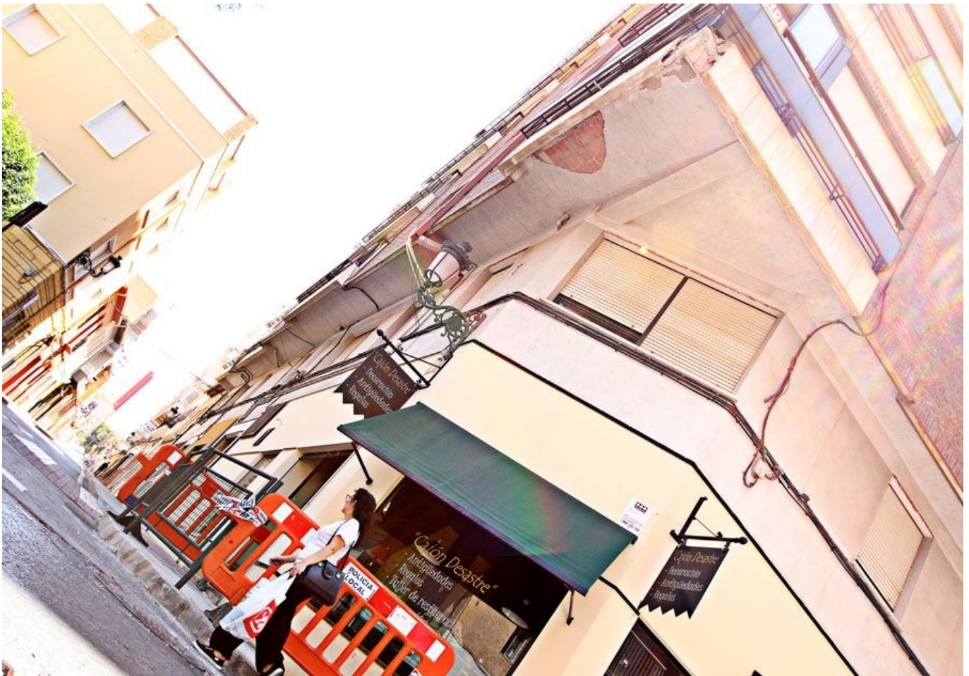
Parte de la fachada se desprendió el viernes | Jesús Cruces
