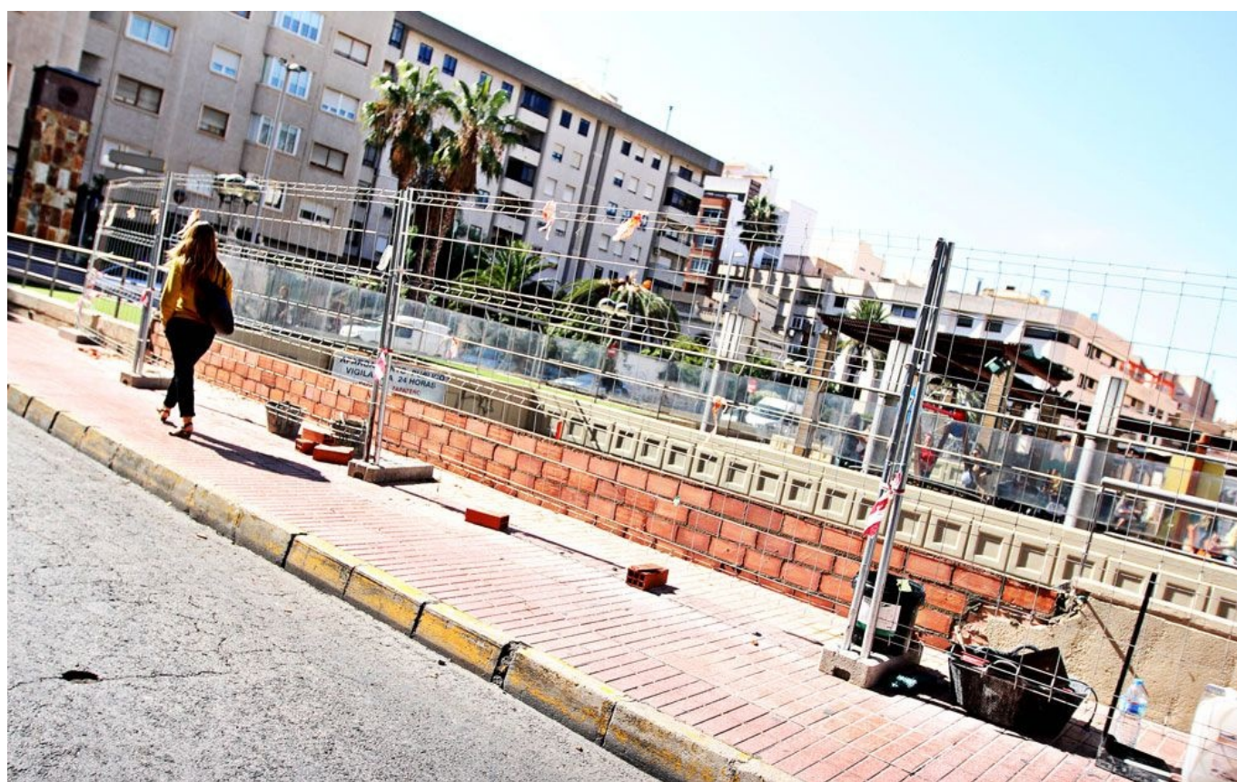
La reparación del muro finalizará antes del fin de semana | Jesús Cruces
