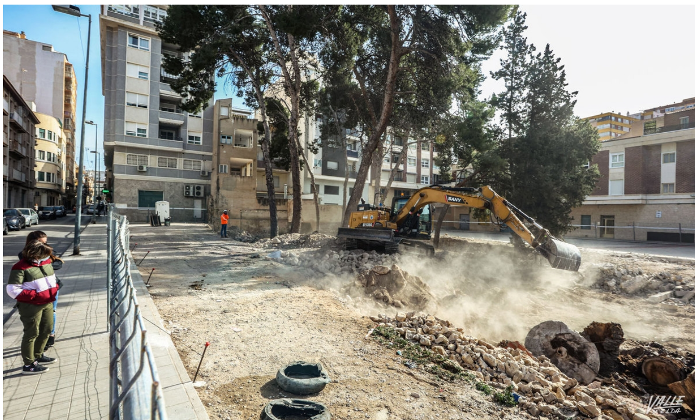
Las obras de la plaza Joan Miró han comenzado esta misma semana | J.C.
