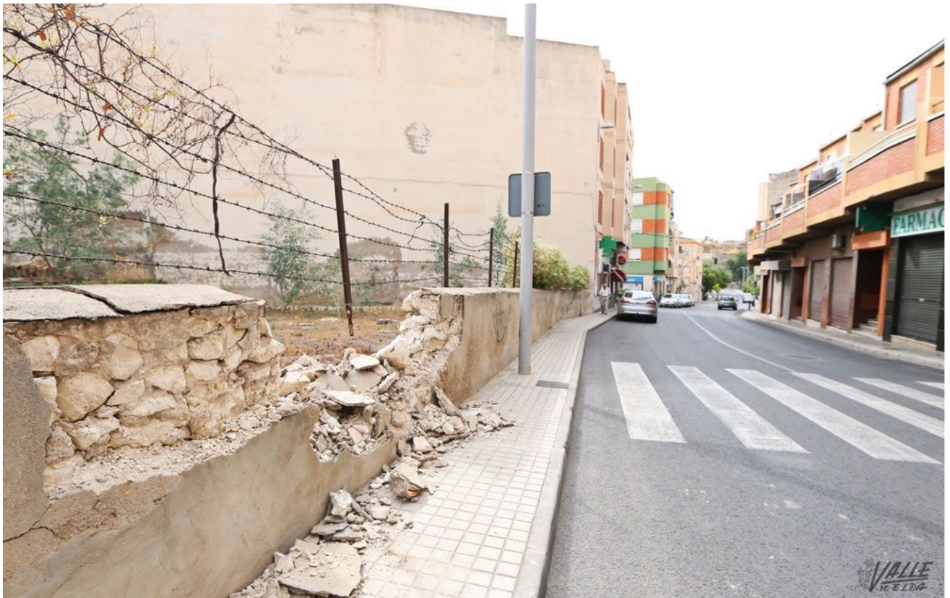
Parte de la valla ha quedado en la acera | Jesús Cruces.
