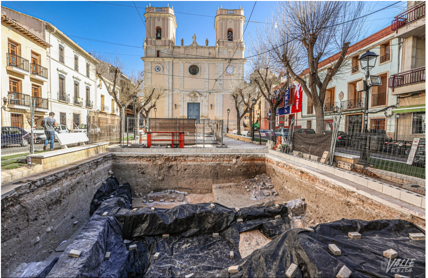
La primera fase de las obras de la Plaça de Baix ya han concluido | J.C.
