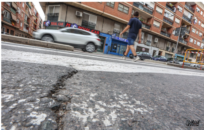
La carretera sufre hundimientos | J.C.
