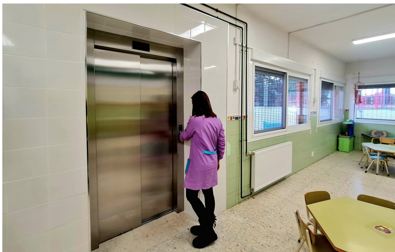
Una de las mejoras en el centro ha sido la instalación de un ascensor.
