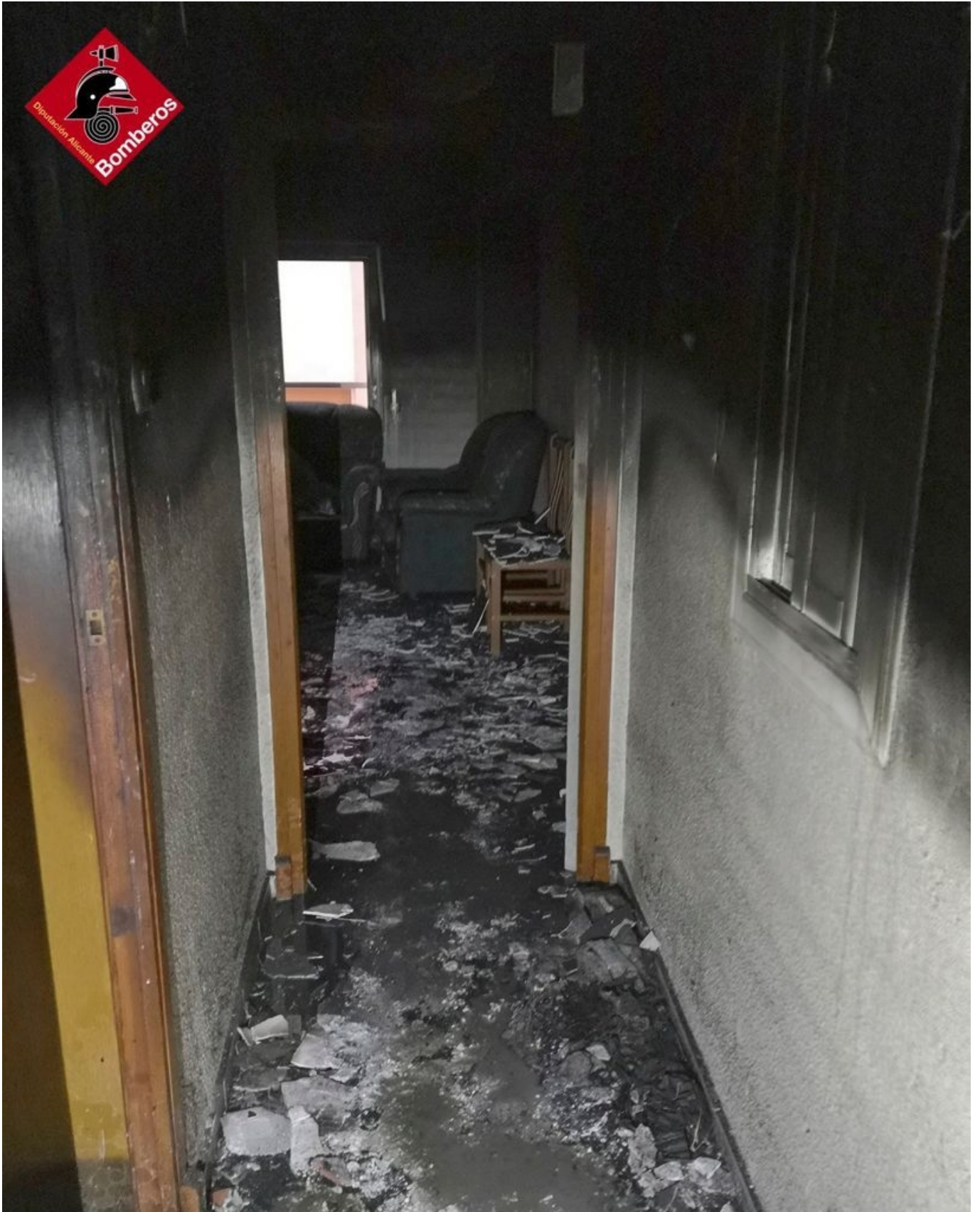
Imagen de la vivienda calcinada.
