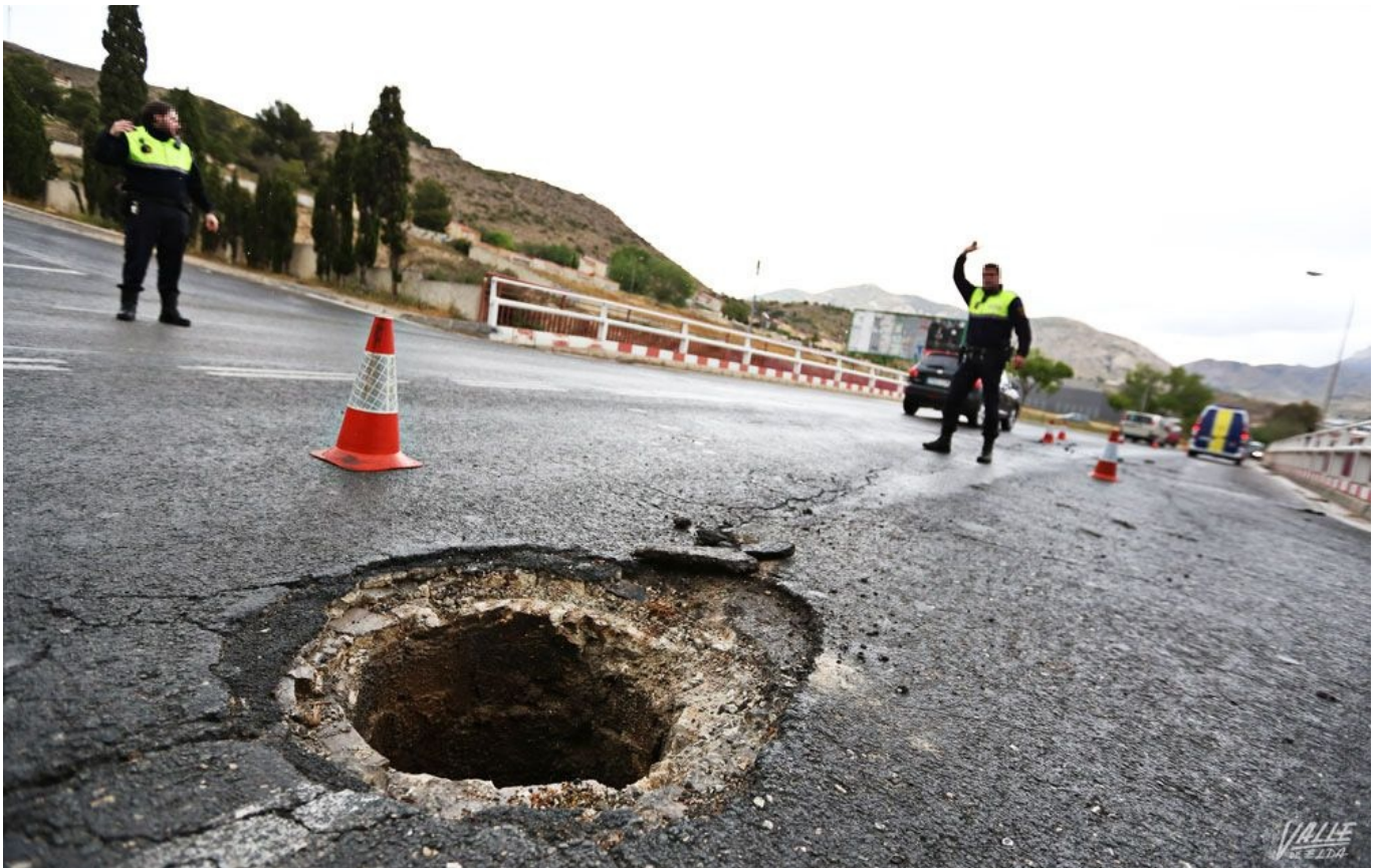
La rotura de la alcantarilla ha dejado un gran agujero en el suelo | Jesús Cruces.
