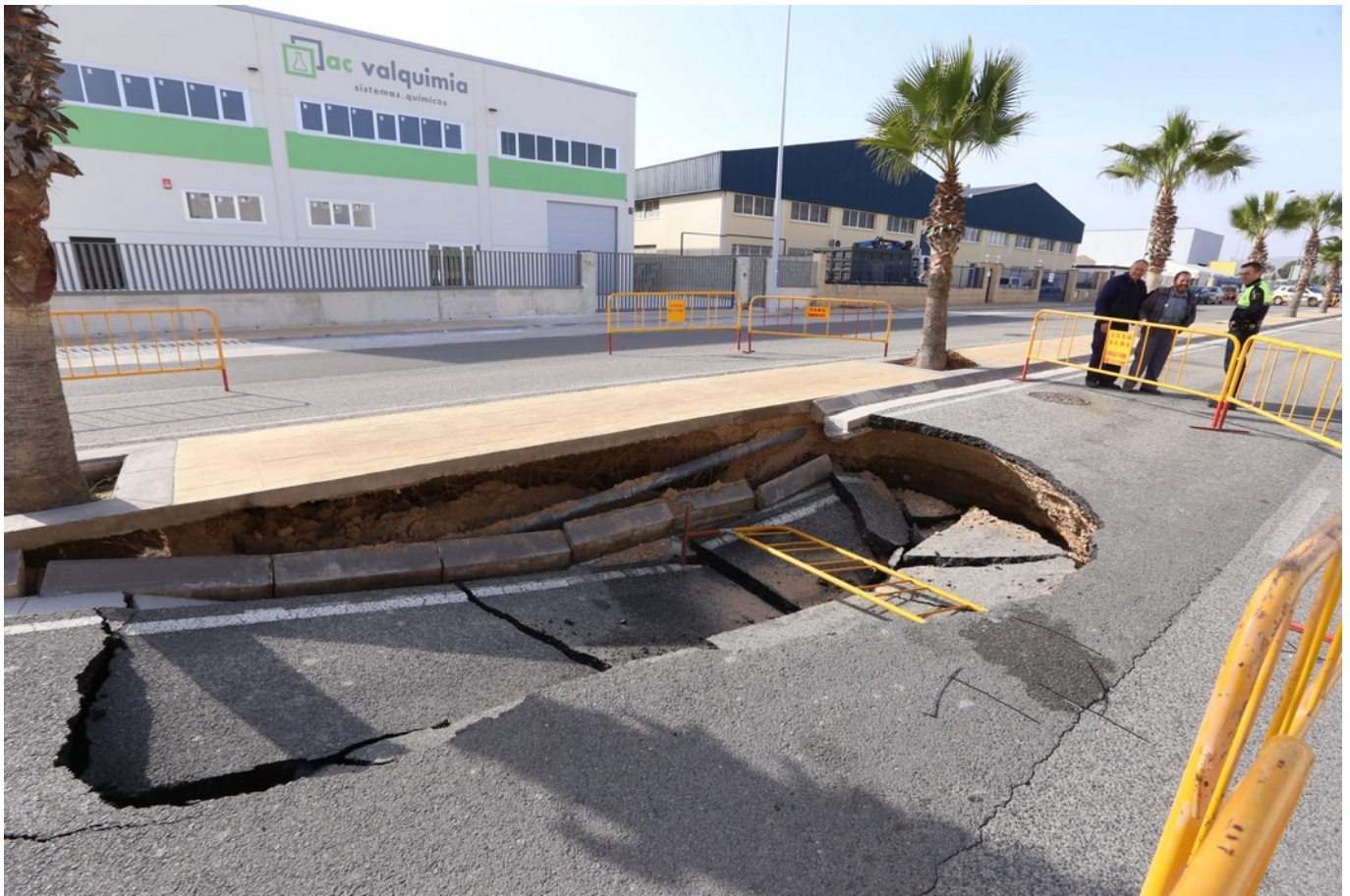
El tramo permanece cortado al tráfico.
