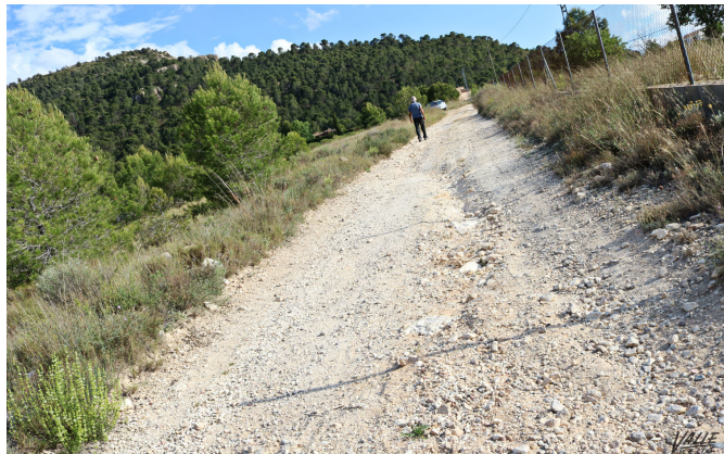
Los vecinos piden "que haya un mantenimiento de esta zona tan deteriorada de Elda" | Jesús Cruces.
