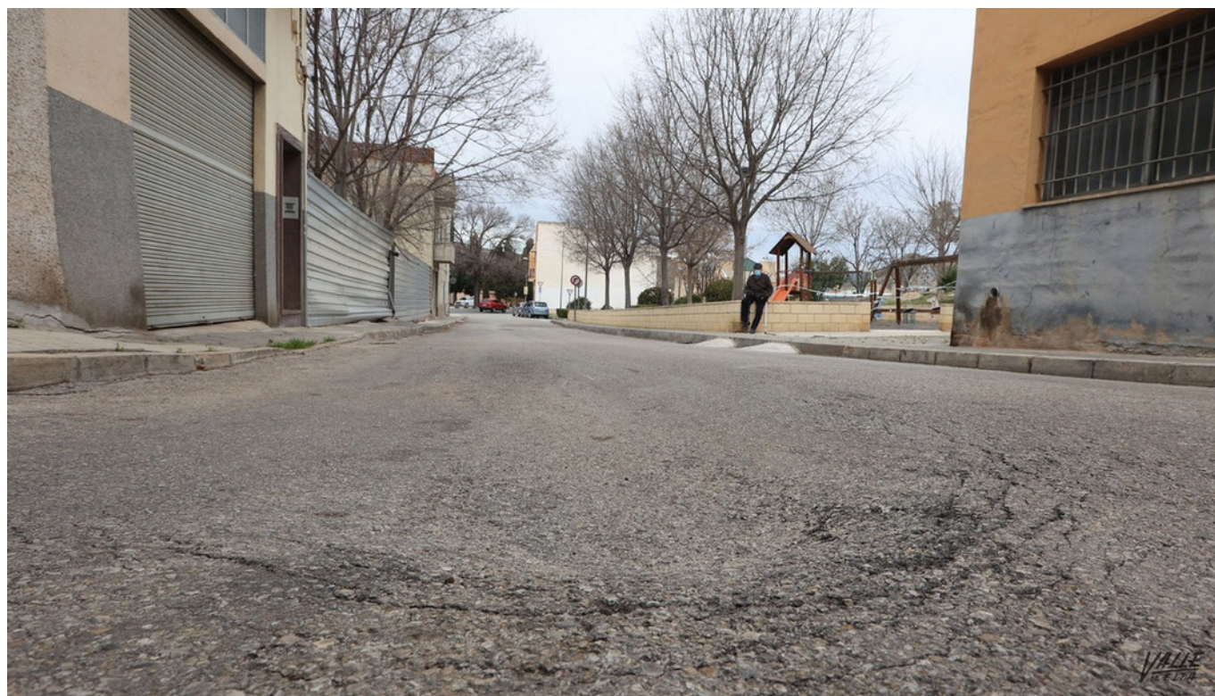
El gran socavón ha obligado a cortar la calle.
