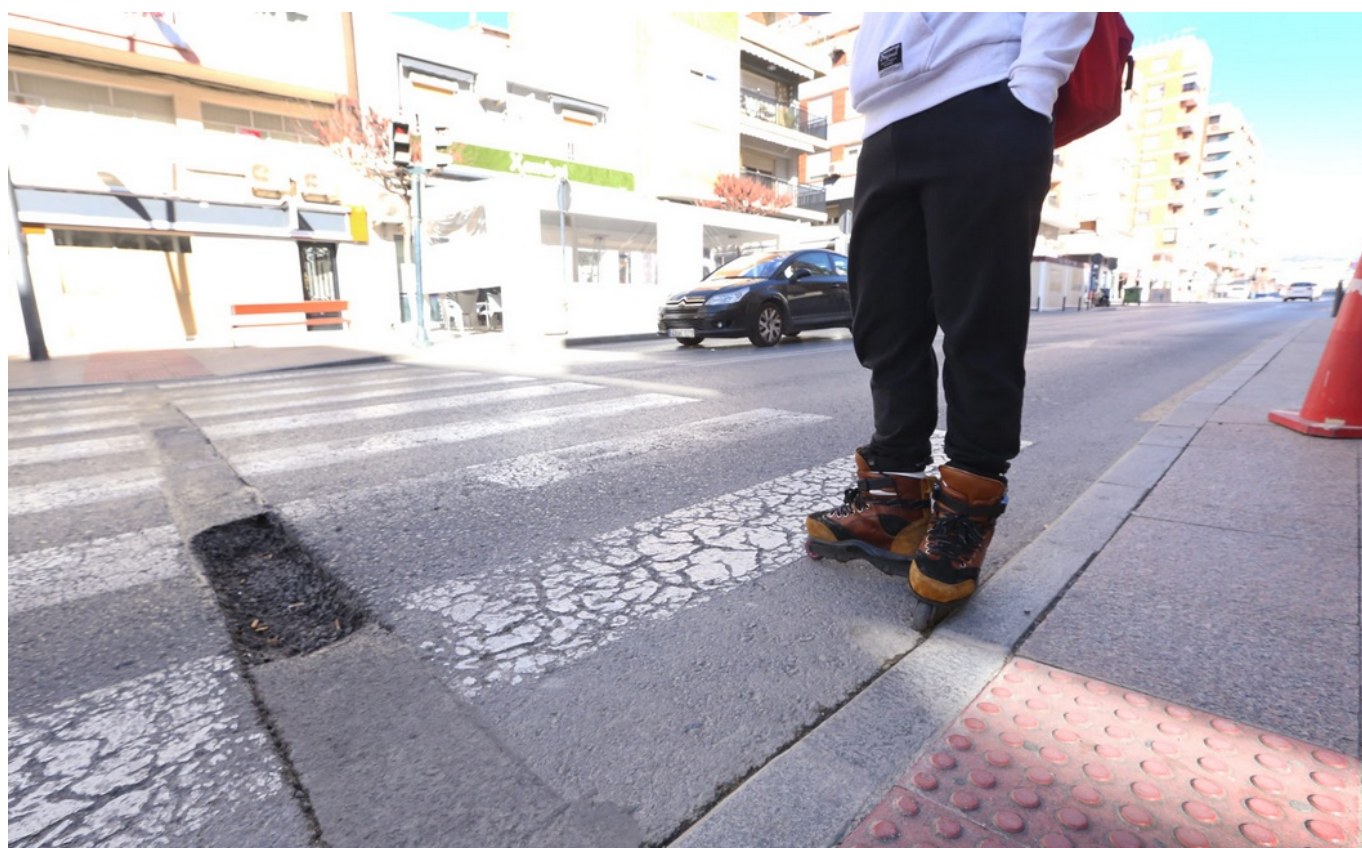
El bache tiene un metro de largo y unos centímetros de profundidad.
