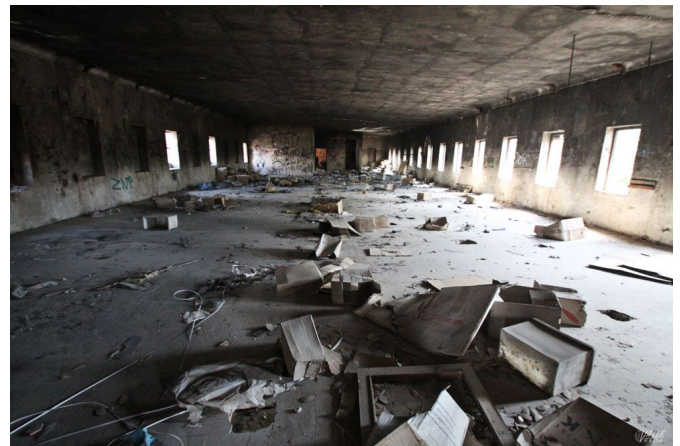
El Ayuntamiento ha intervenido de manera subsidiaria para poder derribar el edificio | Jesús Cruces.
