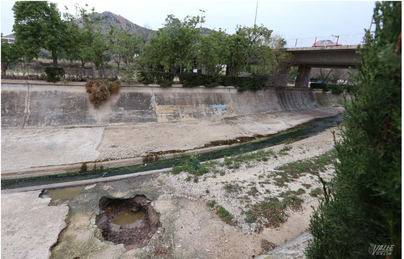
El río tiene un gran agujero por una obra a medio concluir con un mazo abandonado en su interior.
