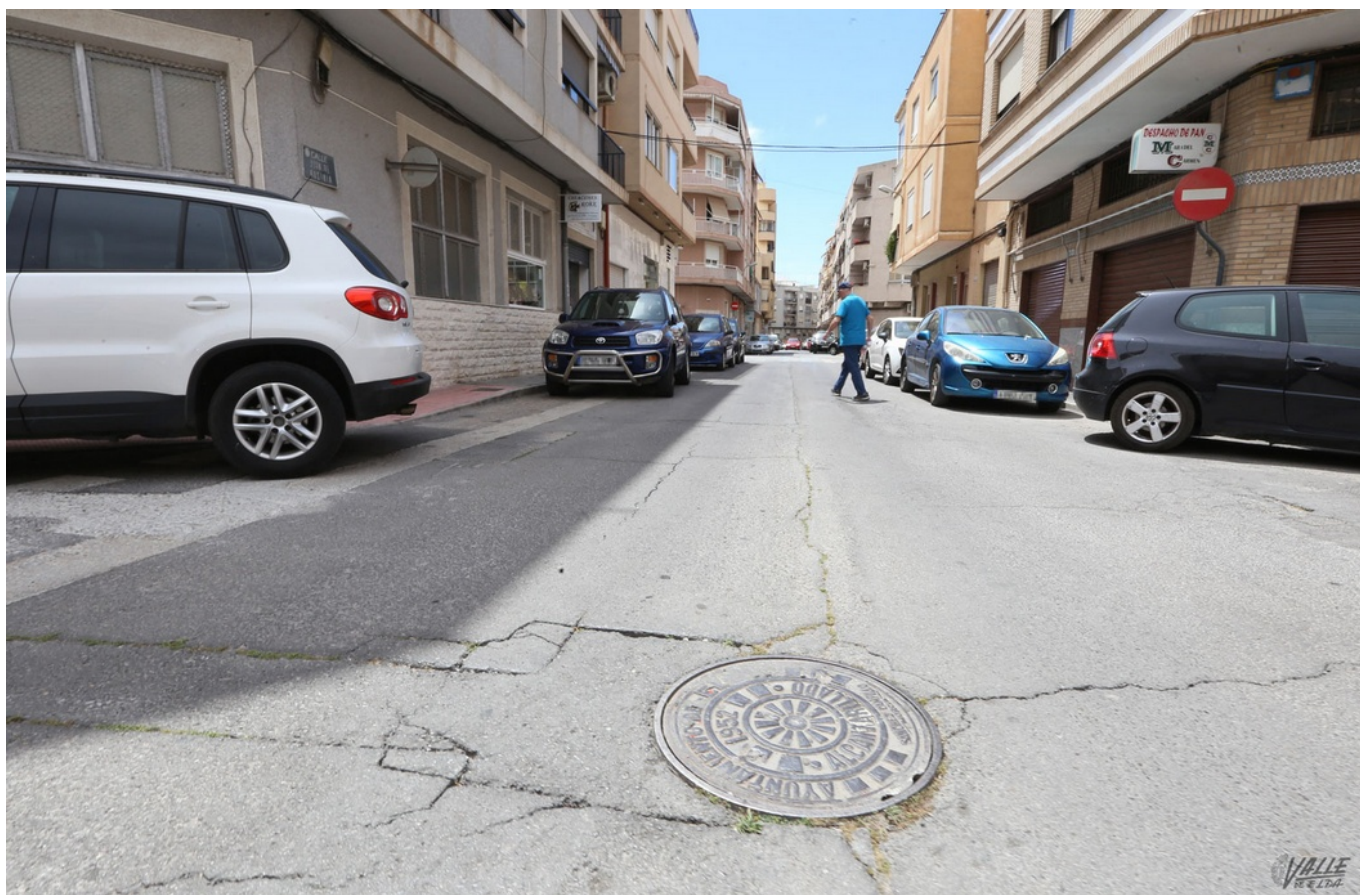
Imagen de los desperfectos de la vía Juan de Austria.
