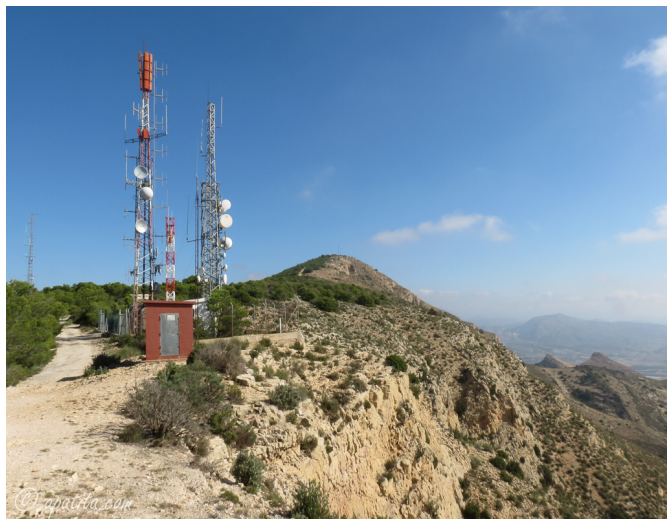
Antenas de telecomunicaciones en lo alto de la sierra del Cid (Chaparrales).
