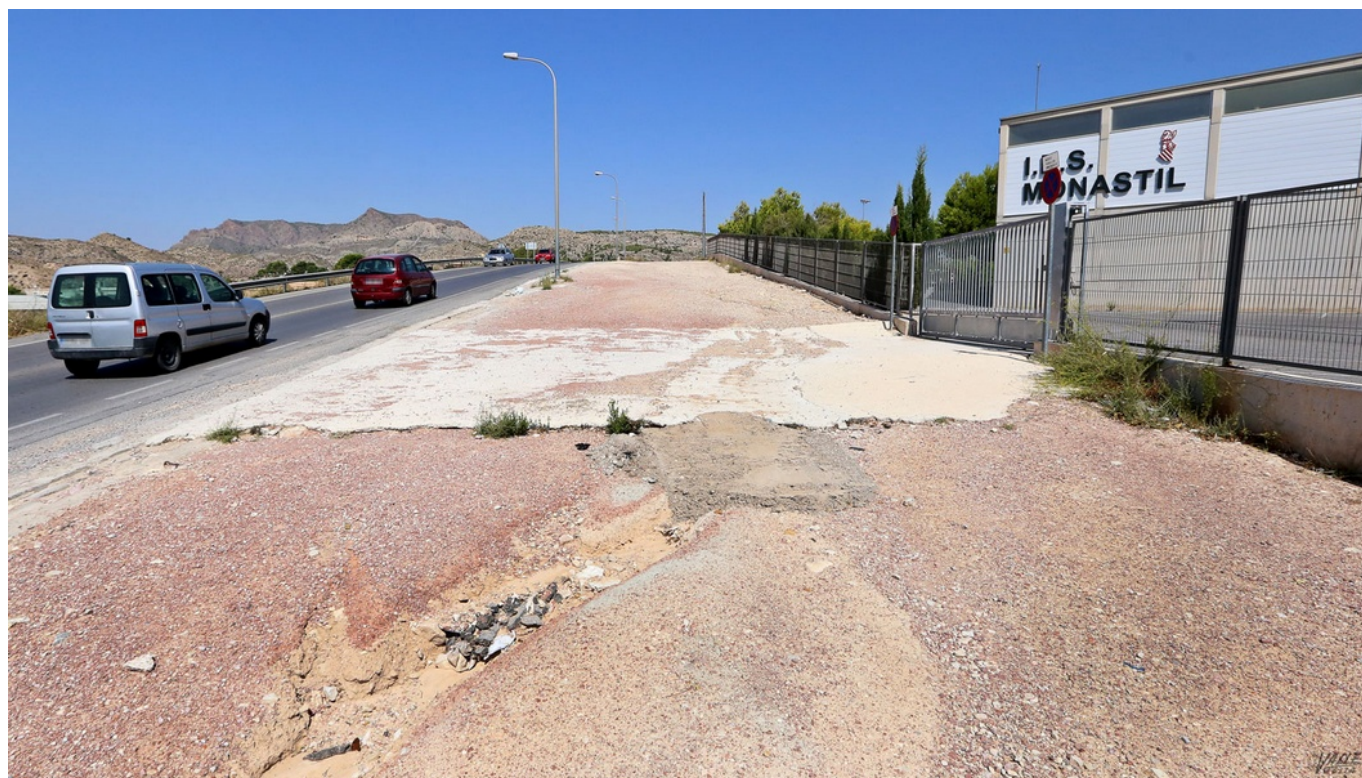
Las obras no se han realizado por tercer verano consecutivo | Jesús Cruces.
