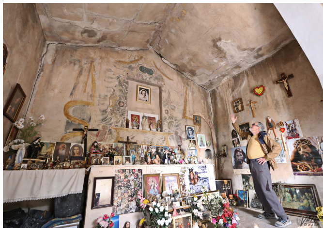
Las grietas son tan profundas que se puede ver desde dentro el cielo | Jesús Cruces.
