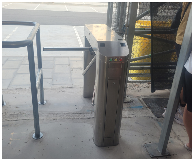
Imagen de uno de los tornos instalados en el Nuevo Pepico Amat | A. J.
