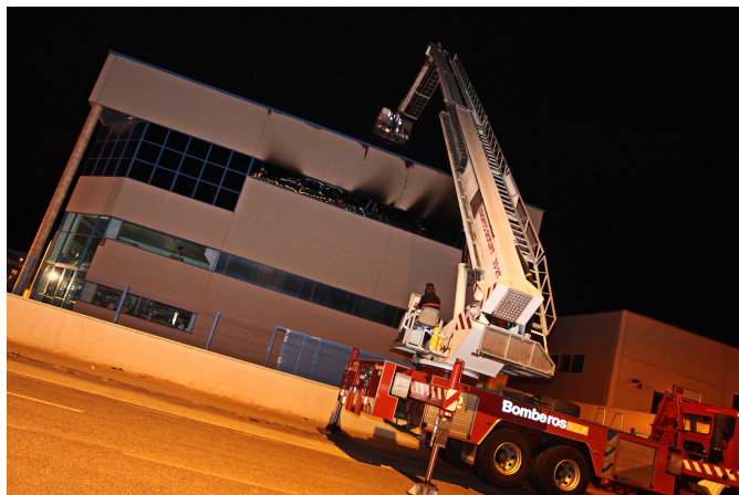
Los daños provocados por las llamas eran visible en la parte superior del edificio | Jesús Cruces
