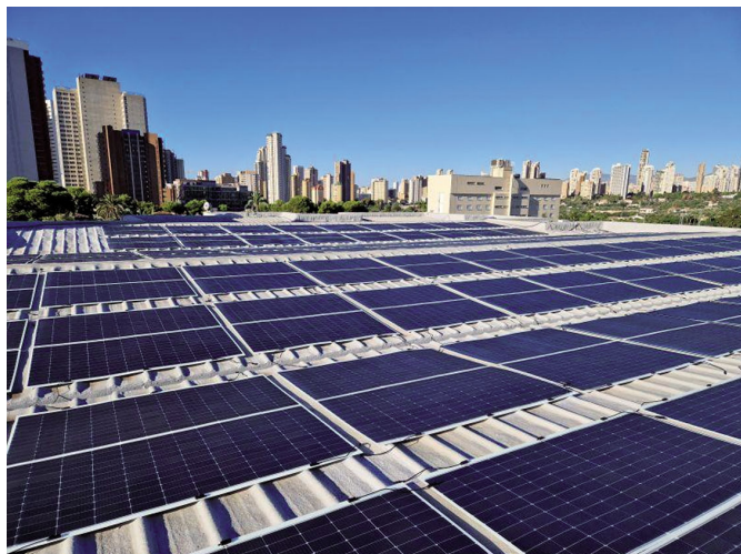
Instalación Benidorm Palace 300 Kw de panel flexible, único en España.
