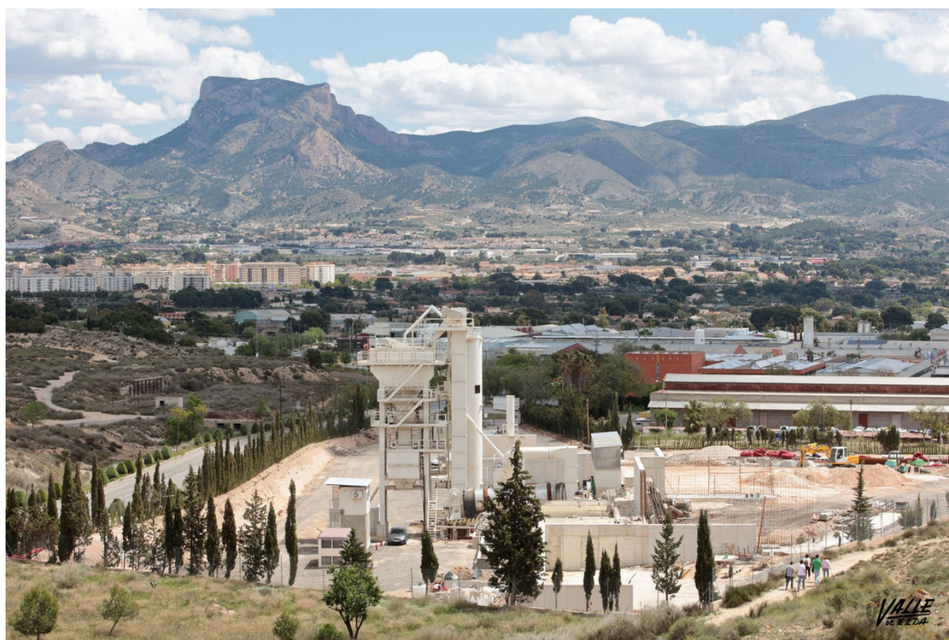
Imagen de la planta asfáltadora.
