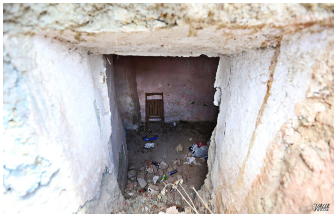
Vista del interior a través de una de las aberturas | Jesús Cruces.
