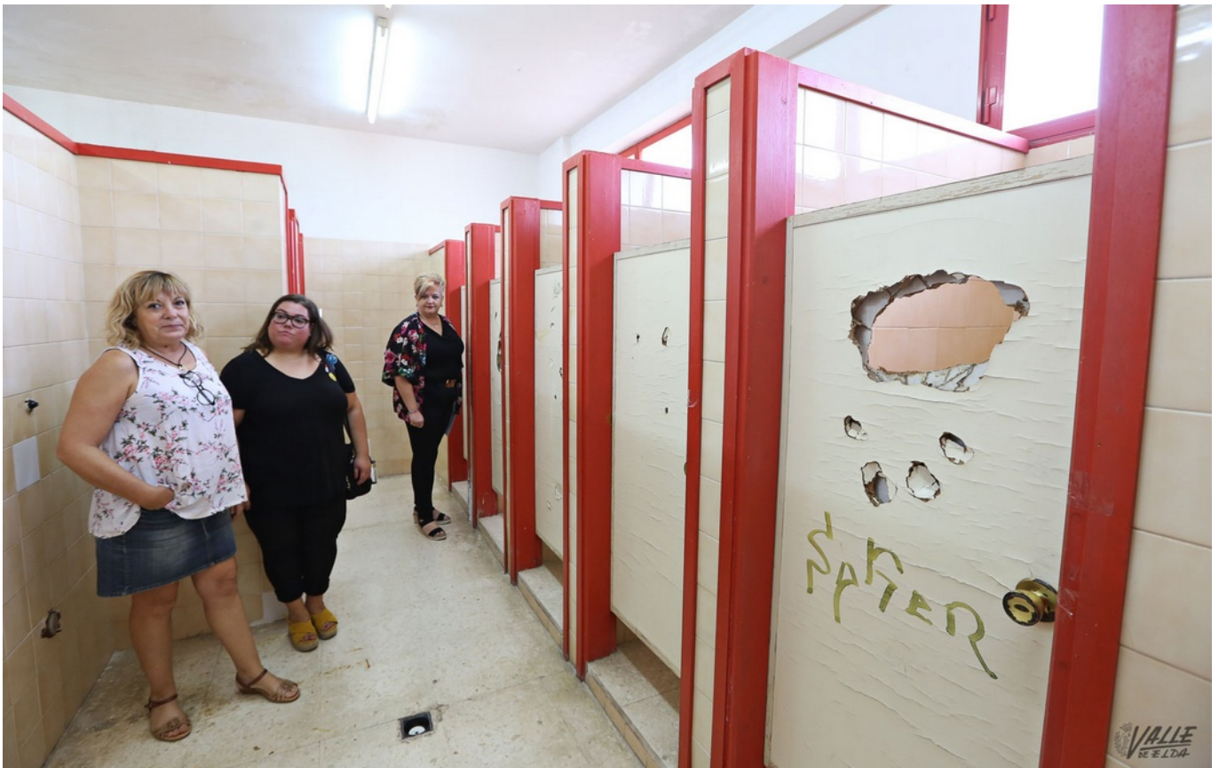
Los baños no están adaptados y cuentan con puertas destrozadas | Jesús Cruces.
