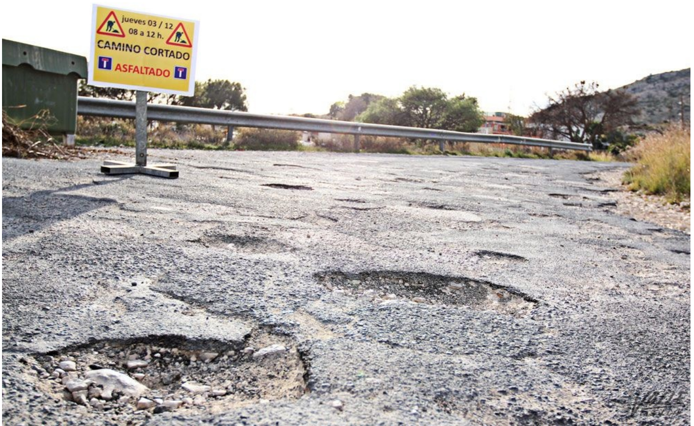
El estado actual de la calzada dificulta la normal circulación | Jesús Cruces.
