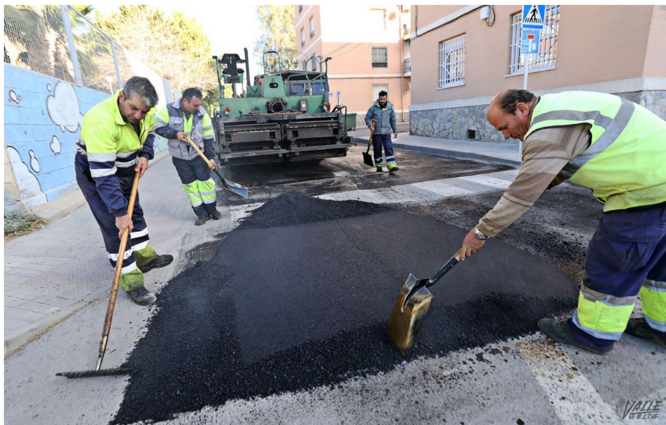
Imagen de archivo del asfaltado de una calle de la ciudad | Jesús Cruces.
