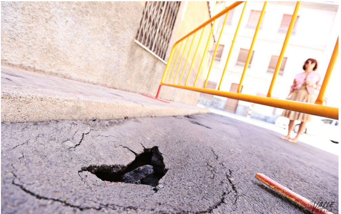
Imagen del socavón de la céntrica y transitada calle | Jesús Cruces.
