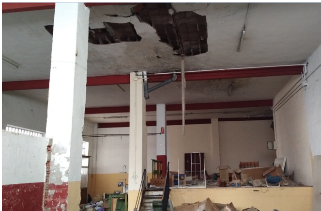
Imagen del estado del local.
