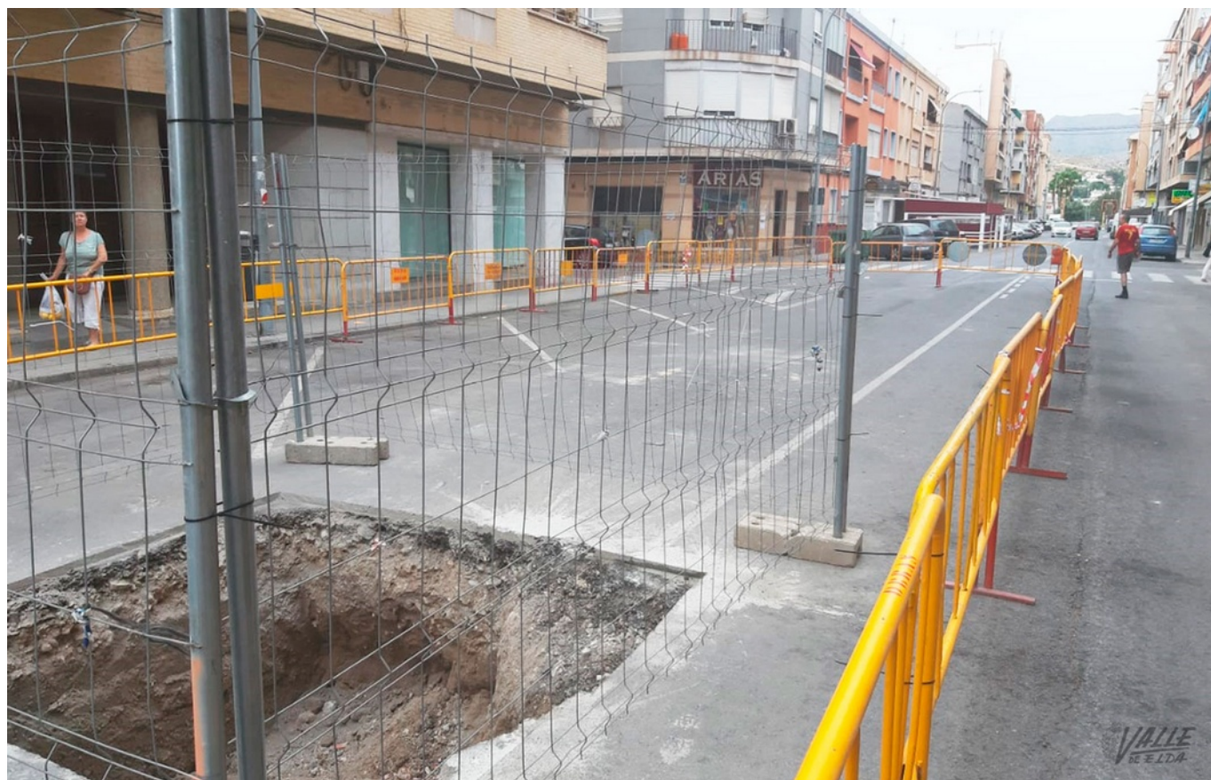
Imagen del socavón que se está reparando.
