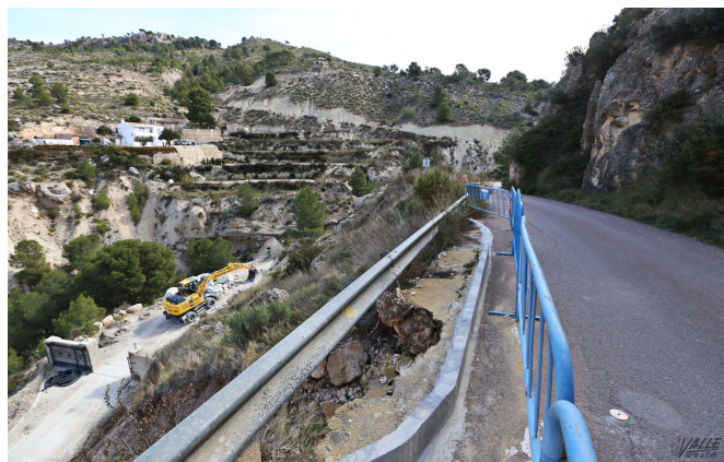
El camino sufrió graves daños por el movimiento de la ladera | Jesús Cruces.
