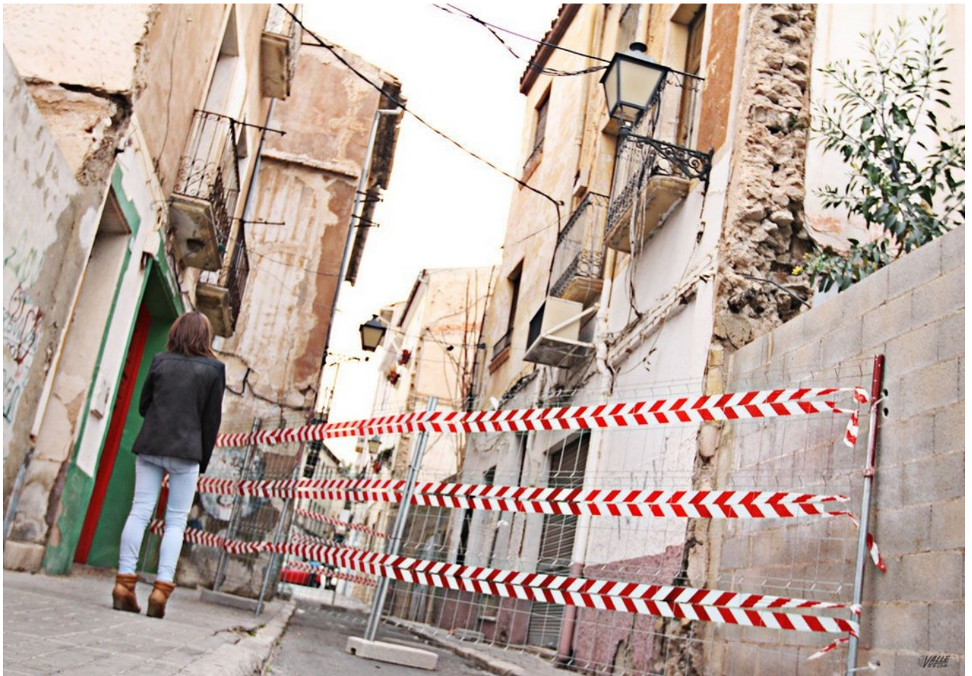
El número 10 de la calle La Purísima sufre peligro de derrumbre | Jesús Cruces.
