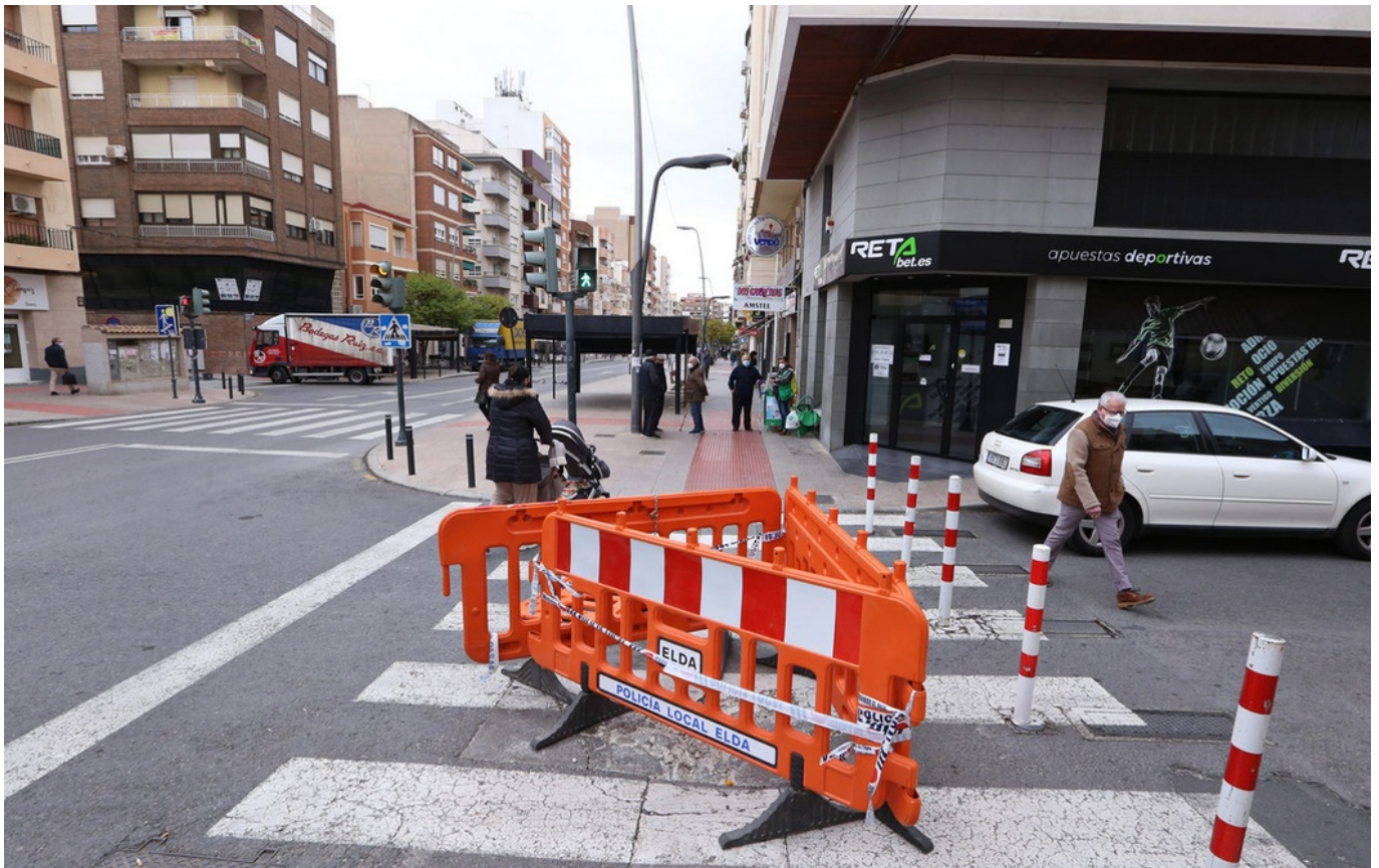
El socavón se arreglará en los próximos días.
