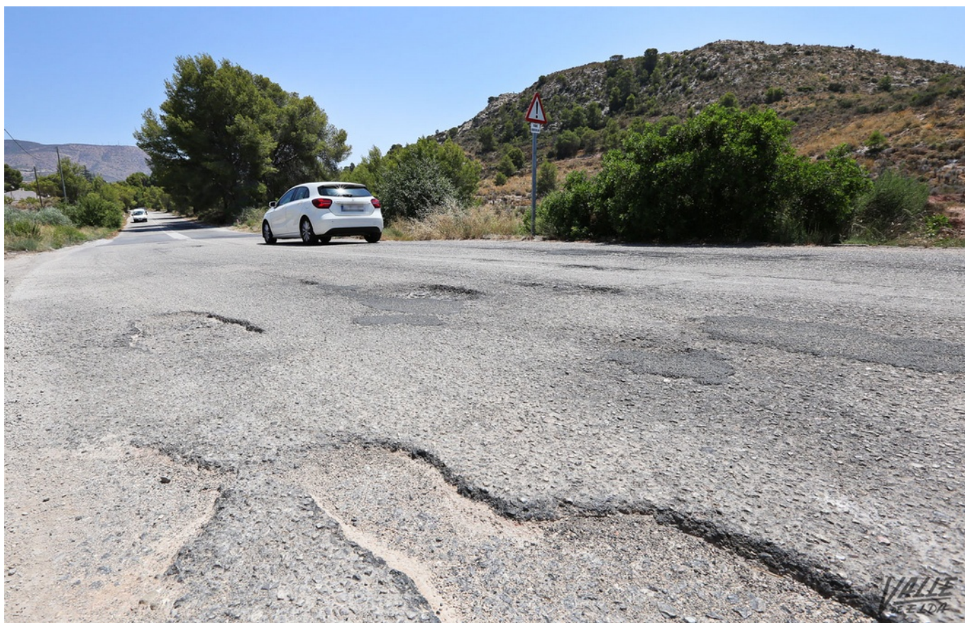
Los hundimientos en el asfalto hacen peligrosa la conducción por la zona | Jesús Cruces.
