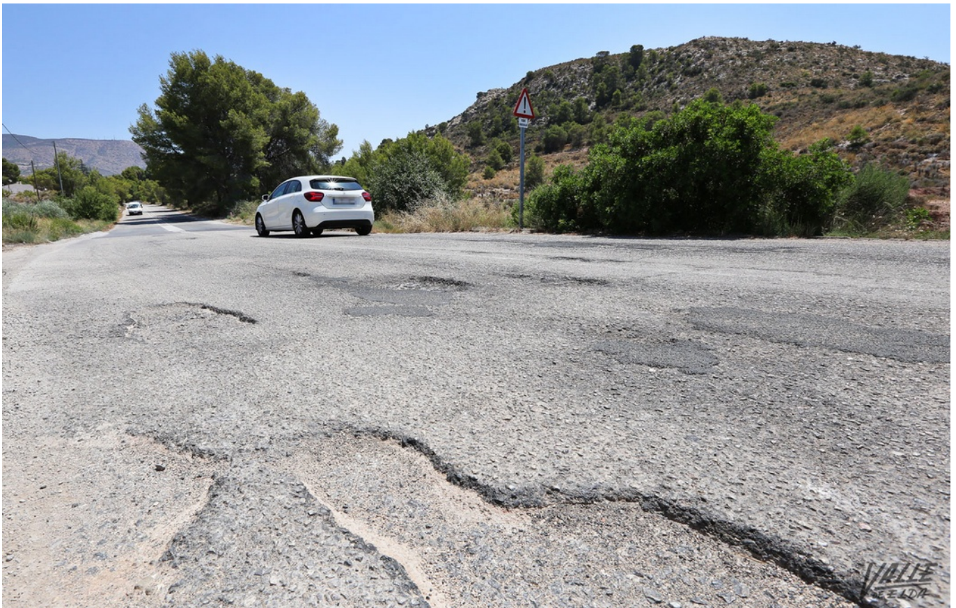
Los hundimientos en el asfalto hacen peligrosa la conducción por la zona | Jesús Cruces.
