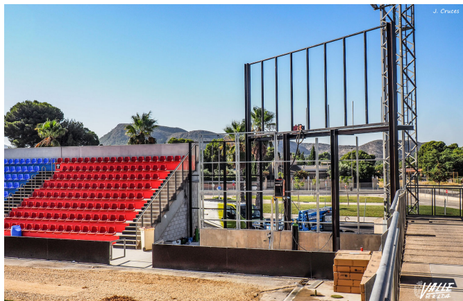
Imagen de los trabajos que se realizan para colocar los nuevos marcadores electrónicos | J. Cruces
