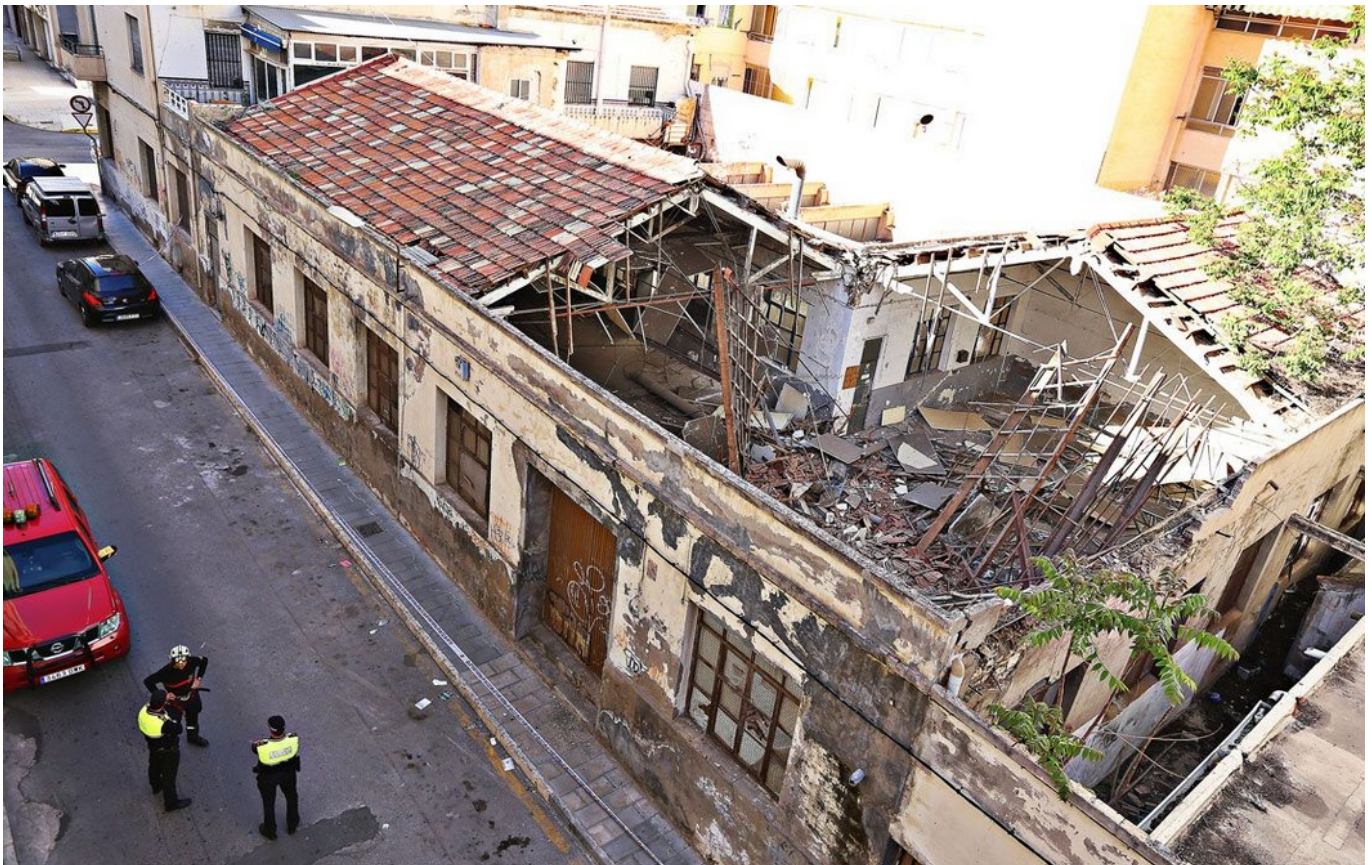
El derrumbe ha provocado un fuerte estruendo que ha alertado a los vecinos | Jesús Cruces.
