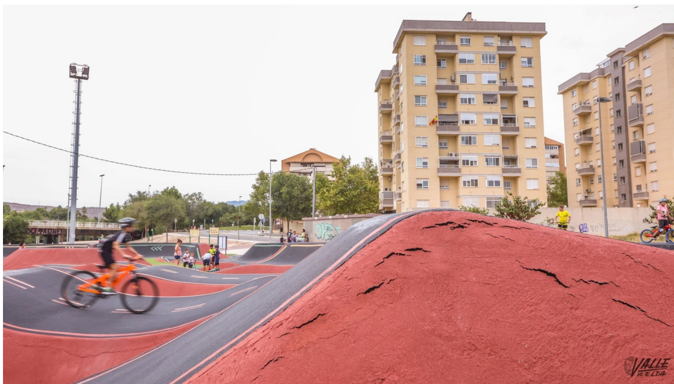
El PP denuncia las grietas que tiene las instalaciones | J.C.
