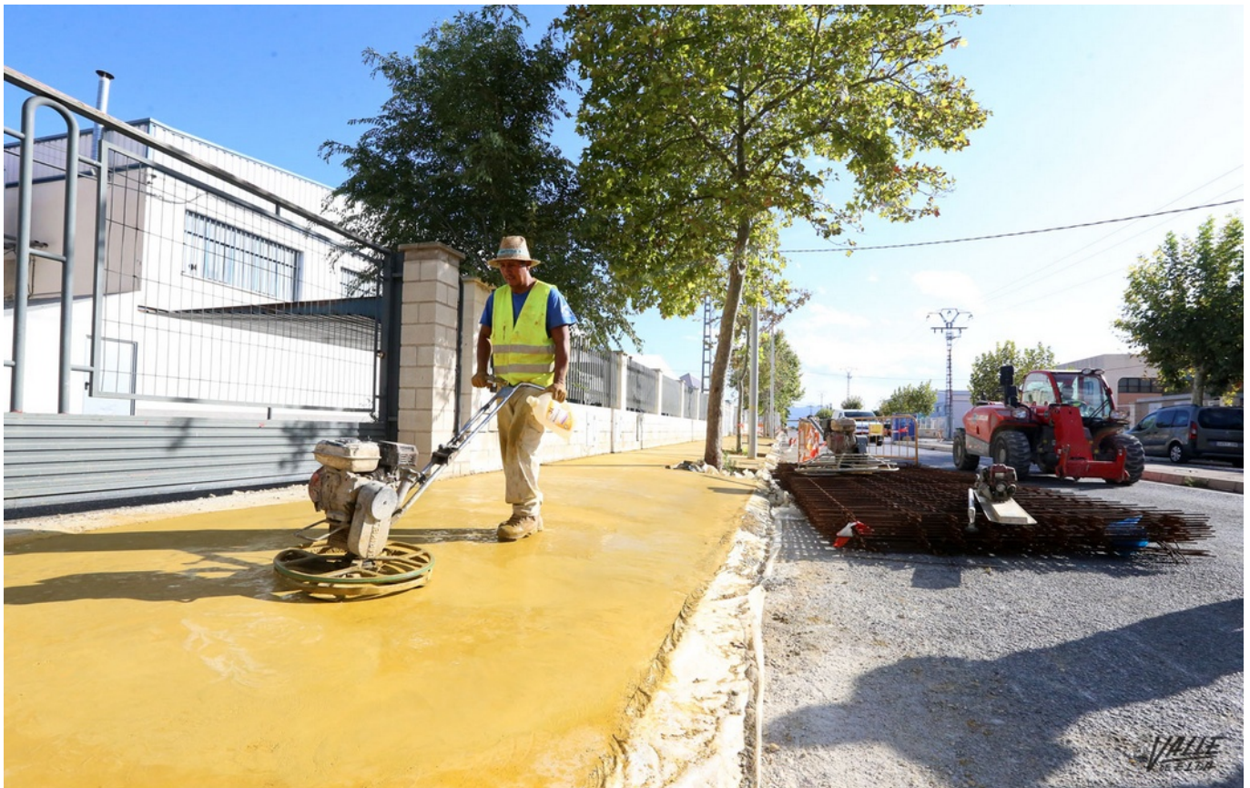
Las obras avanzan a buen ritmo y ya se está instalando la nueva acera.
