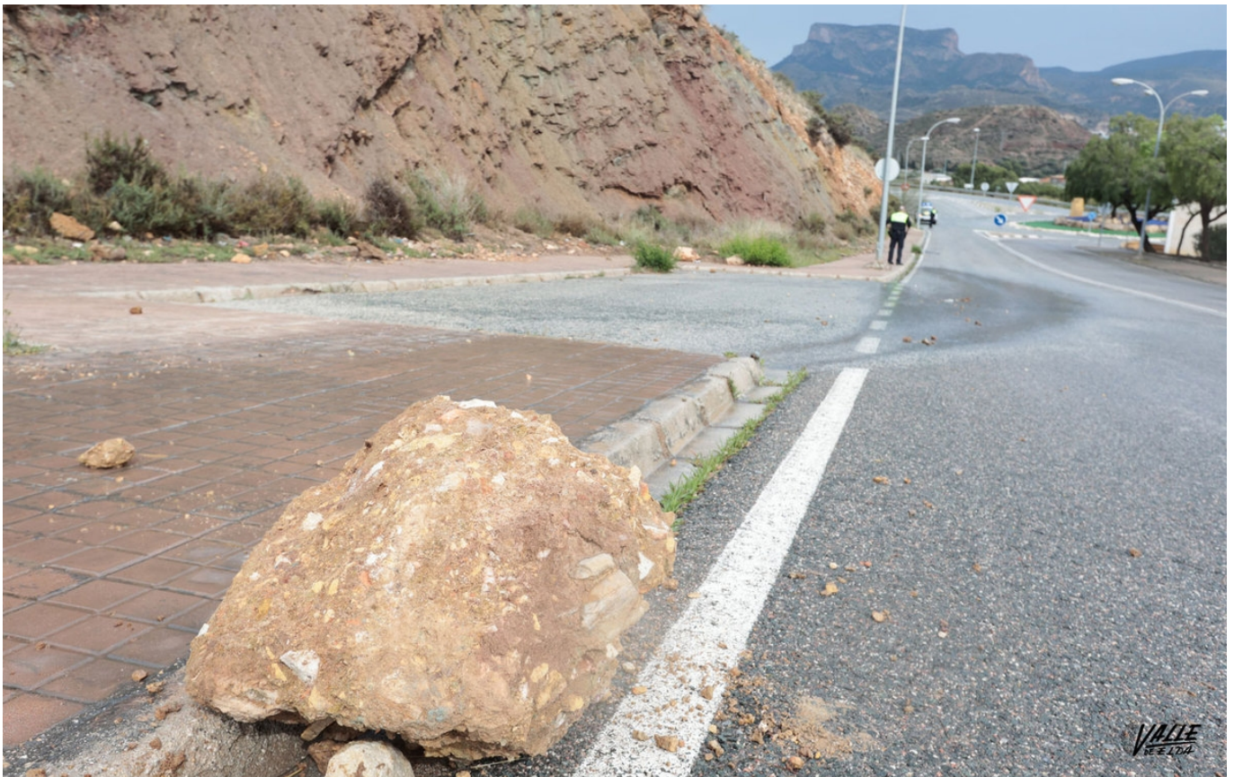
Imagen de las piedras desprendidas.
