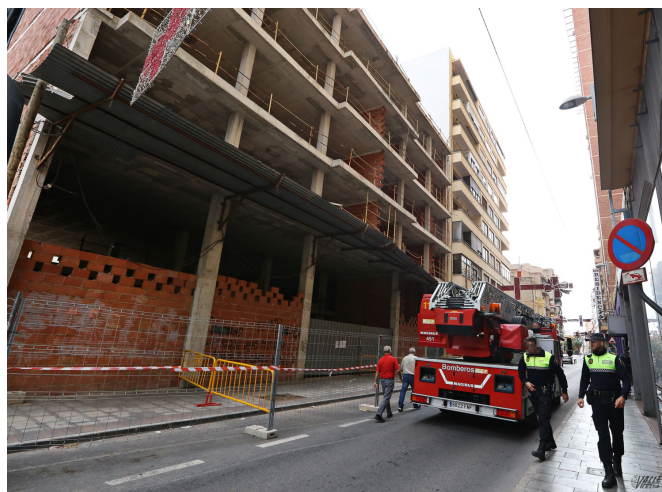
Los bomberos han reforzado la chapa de un edificio en la avenida de Chapí | Jesús Cruces.
