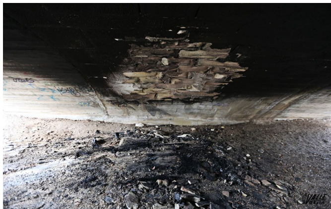
El fuego ha provocado desperfectos en el puente | Jesús Cruces.
