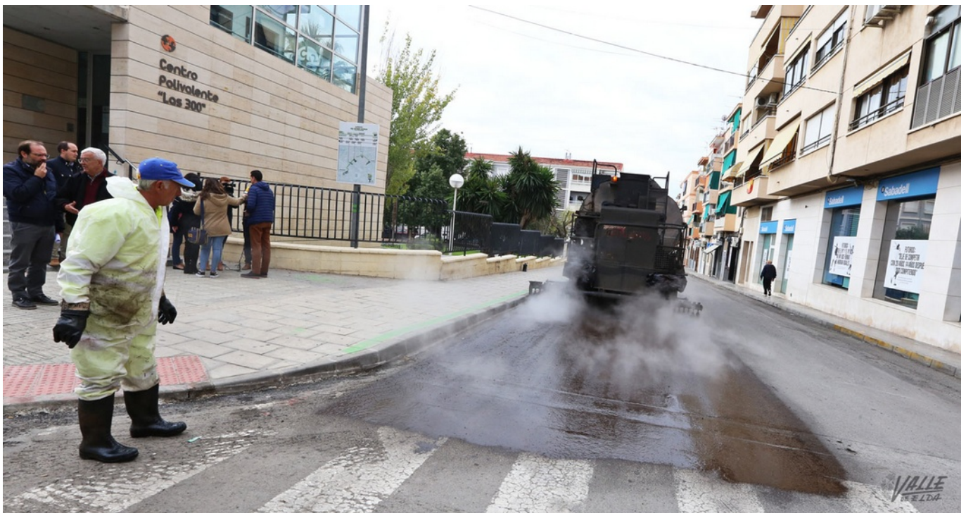
Esta mañana se han realizado trabajos junto al centro polivalente "Las 300" | Jesús Cruces.
