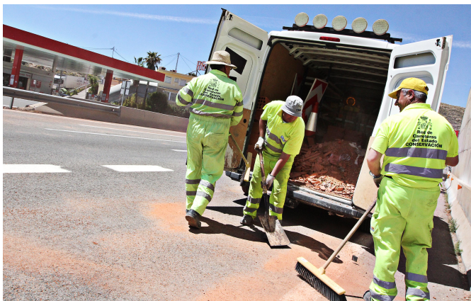
Los ladrillos se han desprendido por la vía | Jesús Cruces
